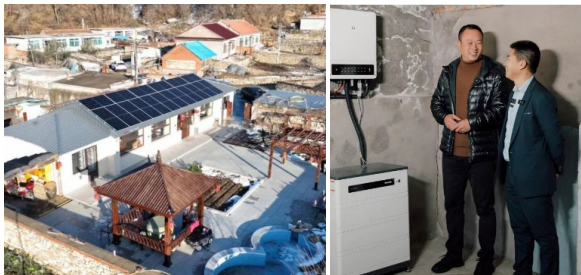
乡村光伏电站
