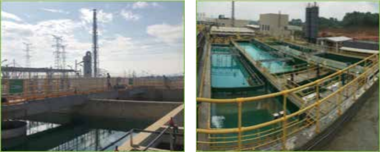
上图：废水处理系统
