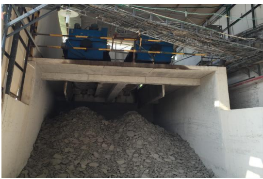
压滤泥回收处理
