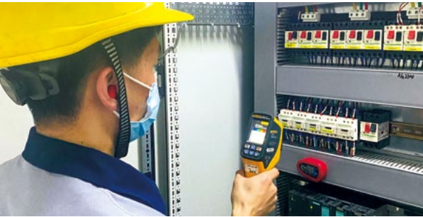
开展岗位级日常电气安全排查
