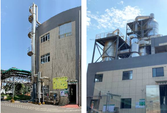
荆门园区“汽提+膜+MVR”组合技术
