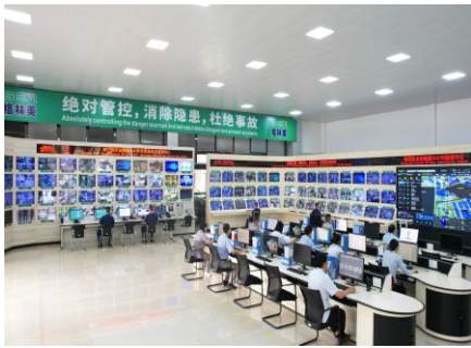
荆门园区24小时安全监控中心
