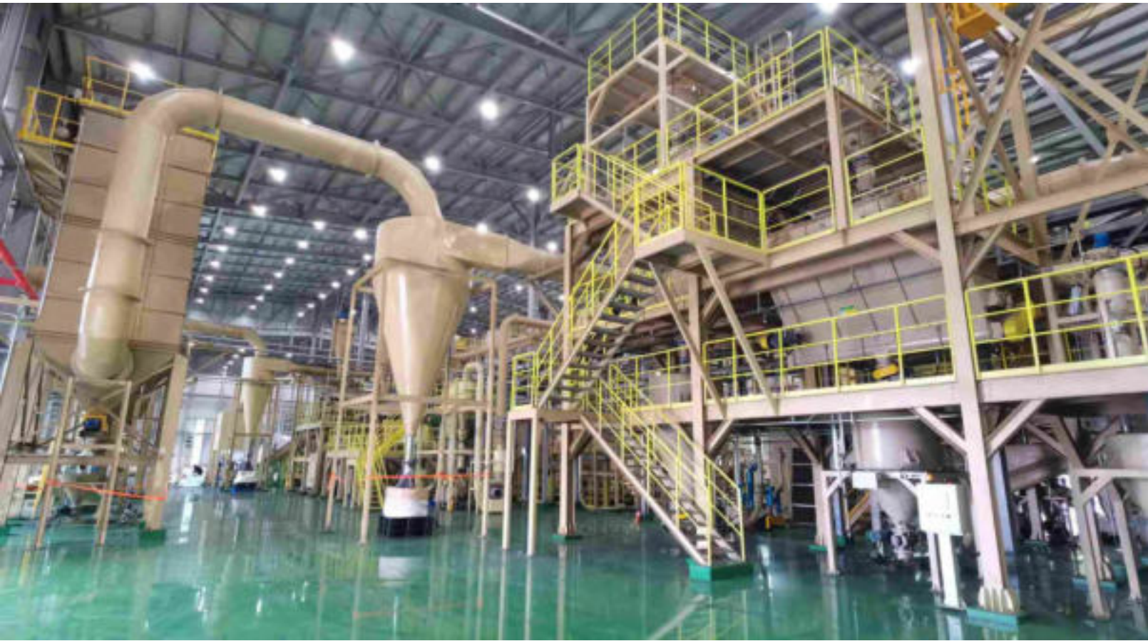
韩国ECOPRO动力电池回收产线
