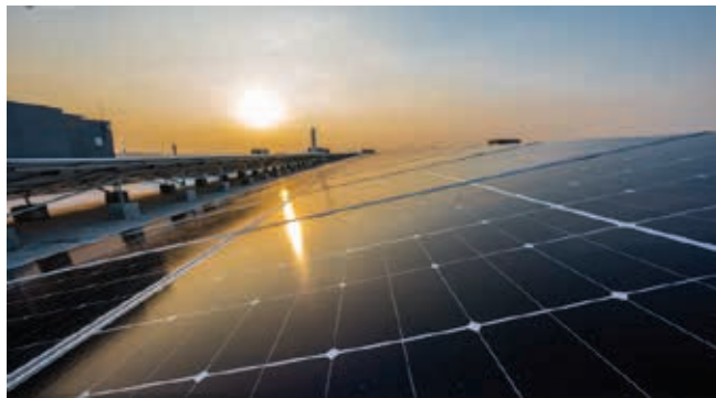
上图为联想在中国天津工厂安装的太阳能电池板。
