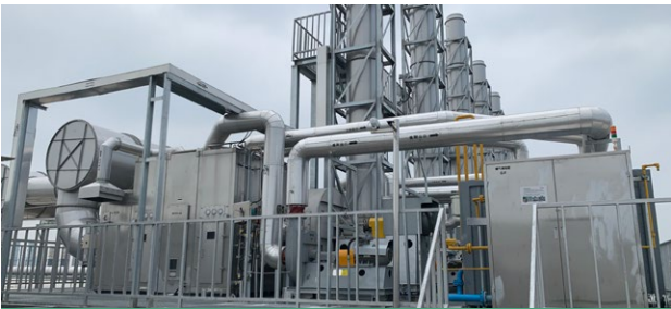
无锡华润华晶微电子公司 挥发性有机物沸石转轮处理设施
