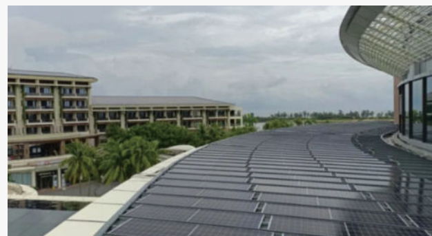
17级台风过境后隆基光伏组件
