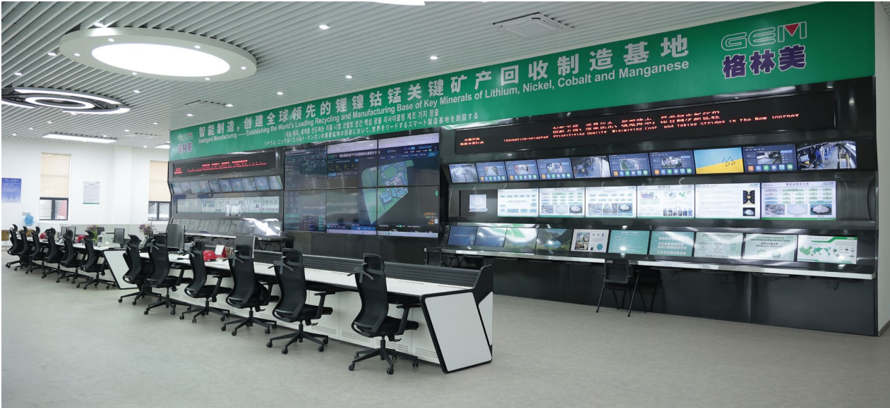
▲ 荆门园区能源数字化管理系统
