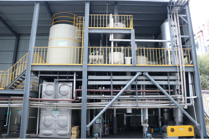
无锡园区生产废水循环利用设施 ▶
