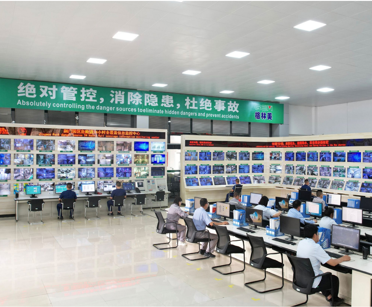
▲ 荆门园区 24 小时安全监控中心
