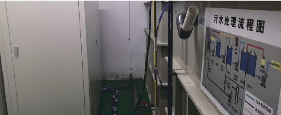
污水处理站维护
