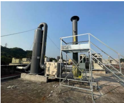
喷淋塔废气处理设施
