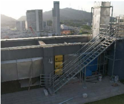
整改后油烟排放口
