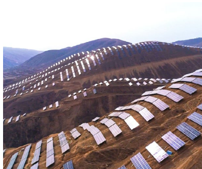
甘肃永靖光伏发电项目
