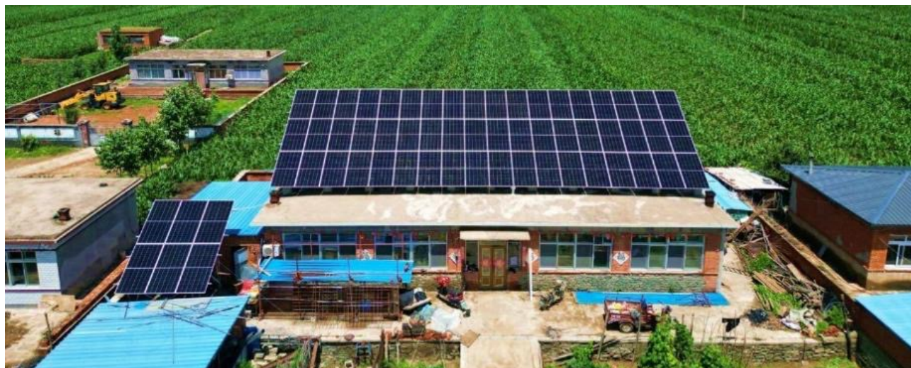
辽宁省朝阳市朝阳县南双庙镇“隆基向日葵”光伏电站
