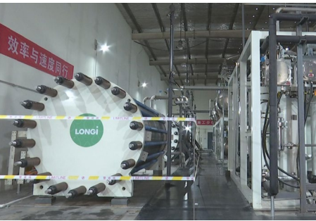
中国石化万吨级绿氢示范项目揭榜挂帅现场
