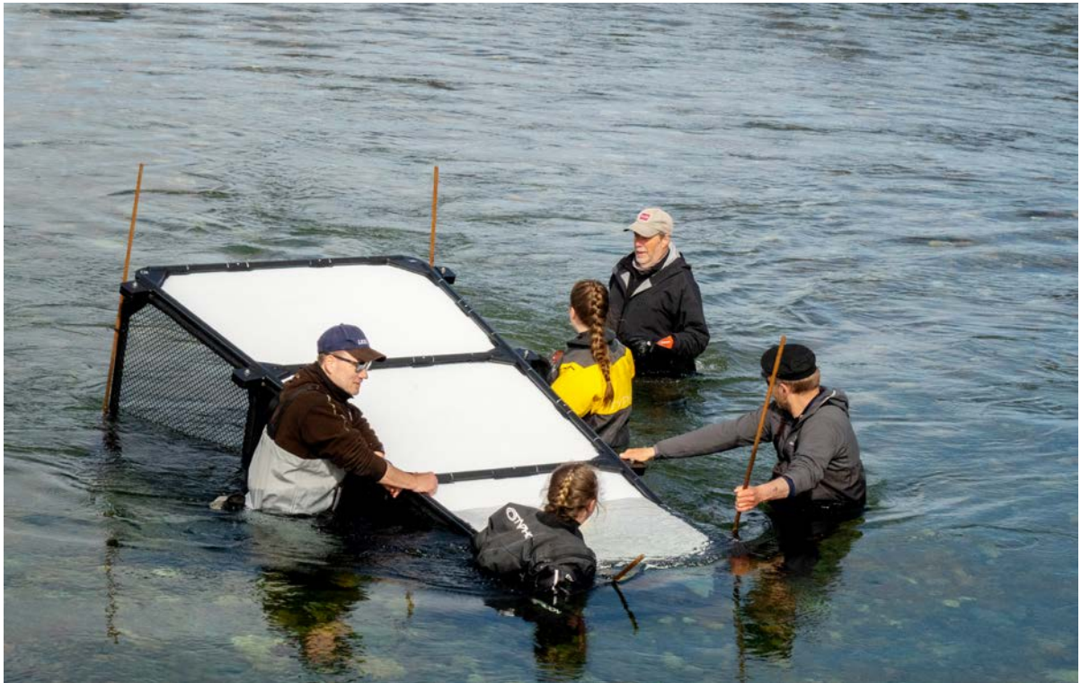
挪威河道管理员和志愿者在安装 AI 实时水下监测系统
