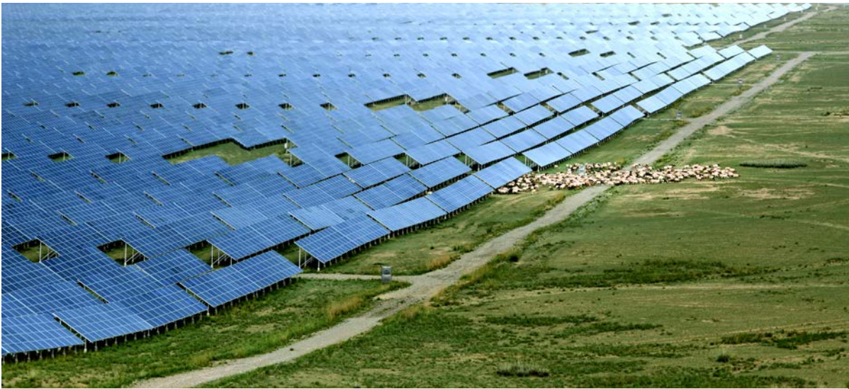
青海共和可再生能源基地：使用华为智能光伏产品，板上发电、板下牧羊，通过特高压通道为 1,500 多公里外的河南省提供绿色电力
