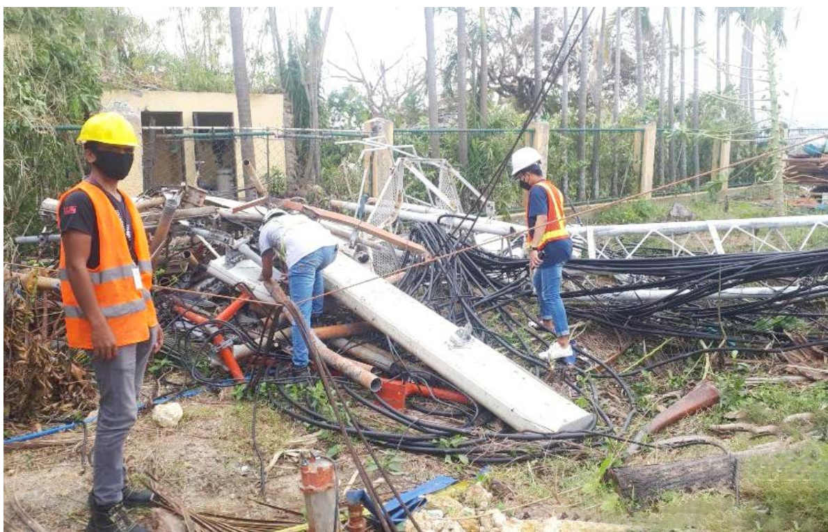
台风摧毁铁塔，华为快速响应，协助通讯恢复
