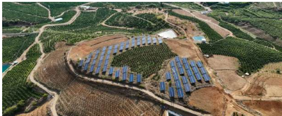
云南光伏泵站
