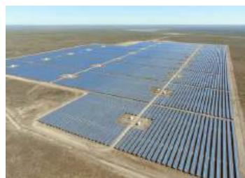
比亚迪太阳能南非地面电站
